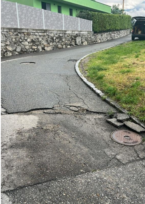
Degrado strutturale del manto stradale a seguito della fuoriuscita dell'acqua di ruscellamento penetrata tra il manto e il sottofondo stradale.
