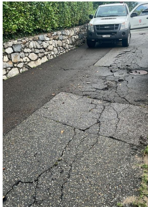
Fessurazioni multiple nel manto stradale e cedimenti strutturali.
